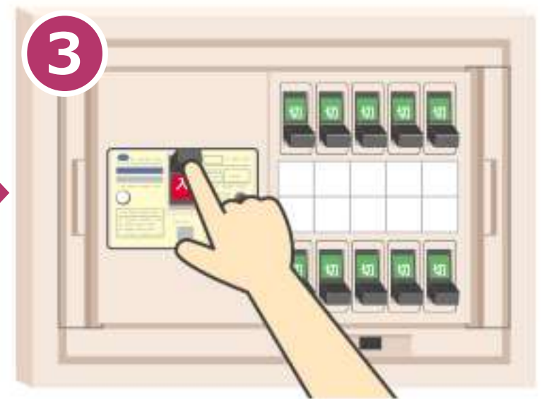
3 漏電遮断器のつまみを下まで下げてから「入」にする
