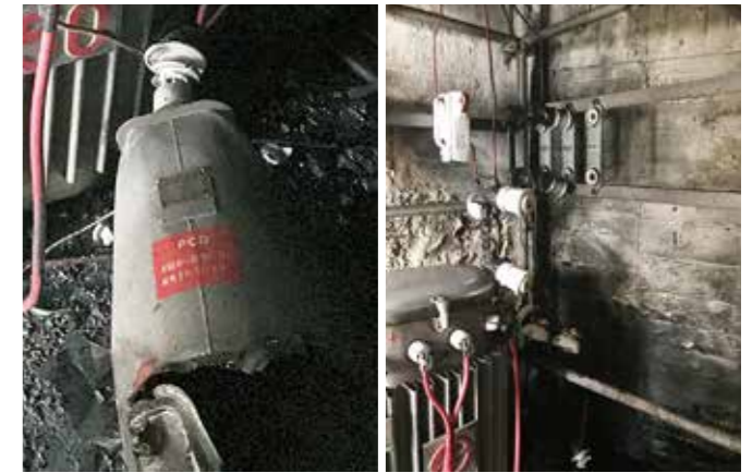
爆発したコンデンサ(左)とPCB含有の絶縁油が飛び散った電気室の内部(右)
